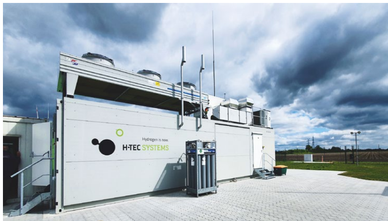
Elektrolyseur in Haurup bei Flensburg.
